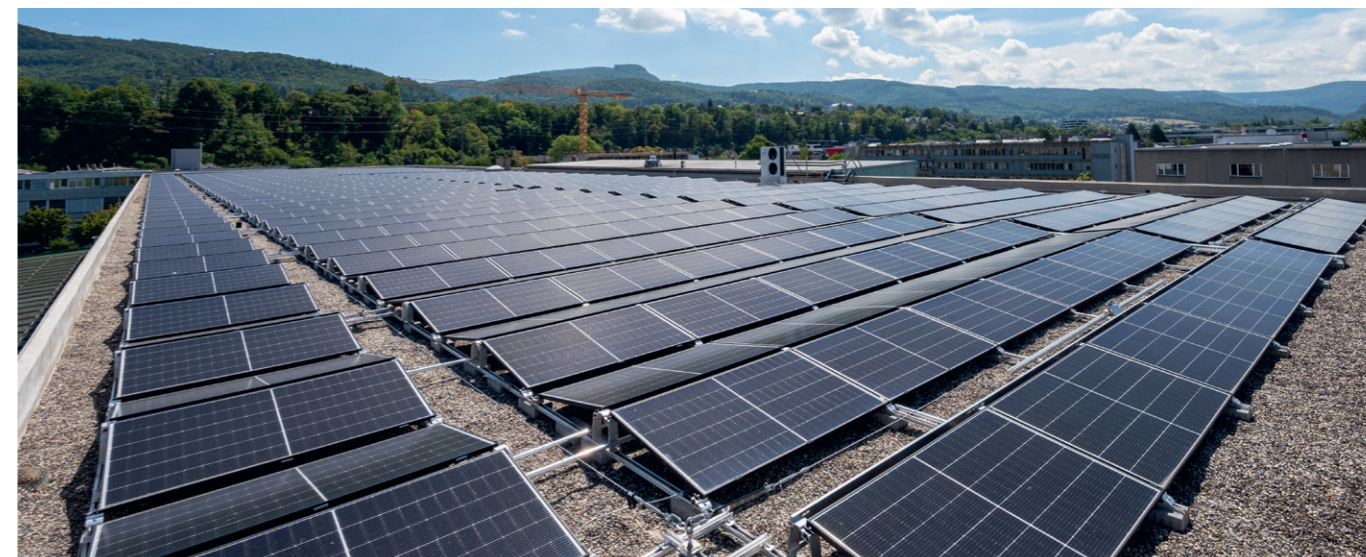
Auf dem Dach der Felix Transport AG in Arlesheim sind 1755 Quadratmeter Solarpanels installiert. BILD: PRIMEO ENERGIE
